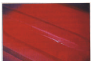
Na een goede (anti)roest behandeling is de reparatie onzichtbaar geworden.
